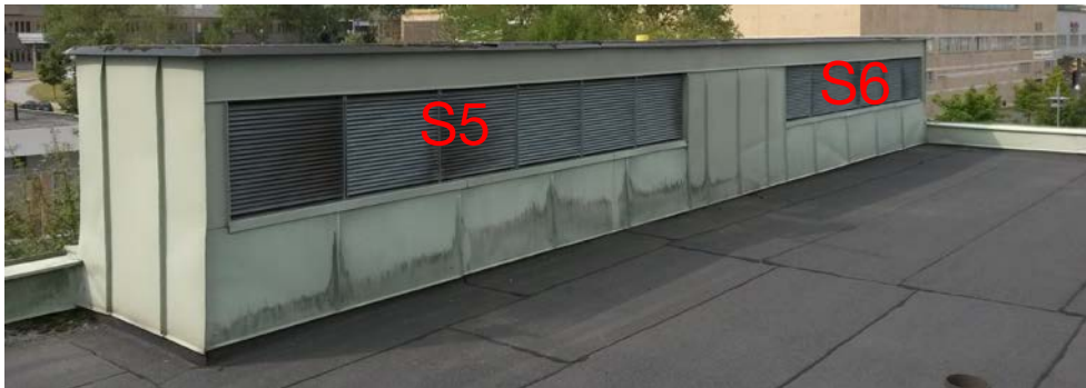
Figur 5. Källa S5 och S6, avluftsgaller. Planerad bebyggelse till höger om bild.
